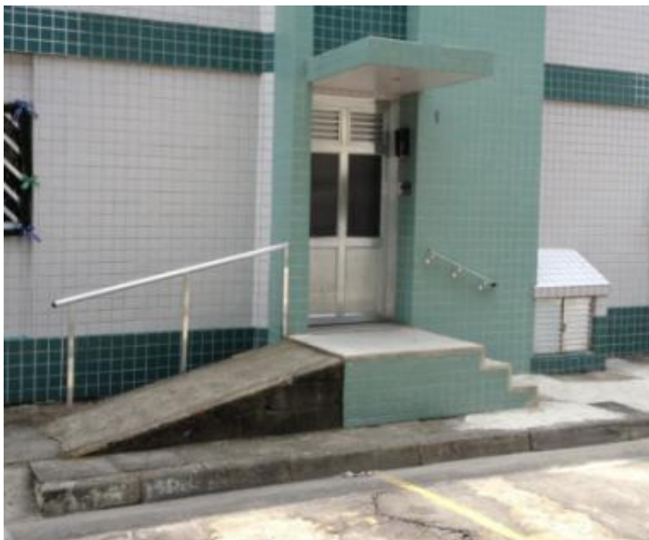
Figura 11 Rampa executada por moradores, fora dos padrões da NBR 9050, sugerida na Instrução Técnica nº 11 do CB de São Paulo.
