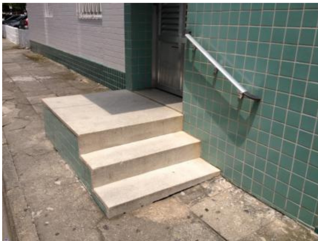
Figura 26: Degraus das escadas com alturas distintas, os acessos não possuem corrimãos adequados e nem rampas de acesso. BNH de Santos-SP.
