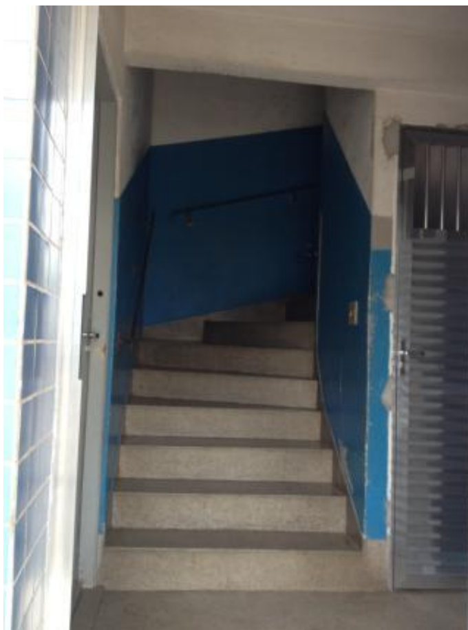
Figura 27: Escadas irregulares (Falta Iluminação e Ventilação). BNH de Santos-SP.
