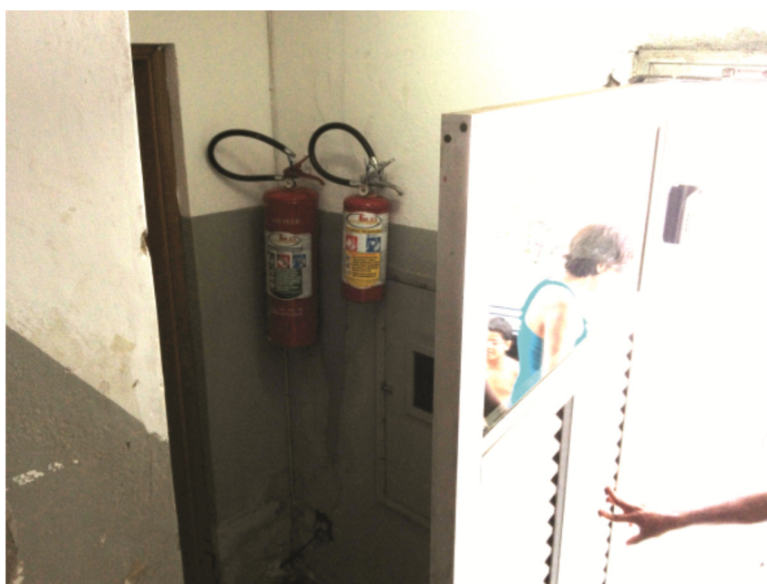
Figura 25: Porta com o acesso obstruído. BNH de Santos-SP.
